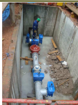
Conduite en exploitation
