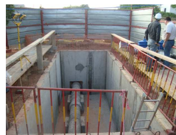
Vérification de la sécurité et des pièces par Lydec
