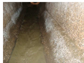
État avant réhabilitation Radier dégradé
